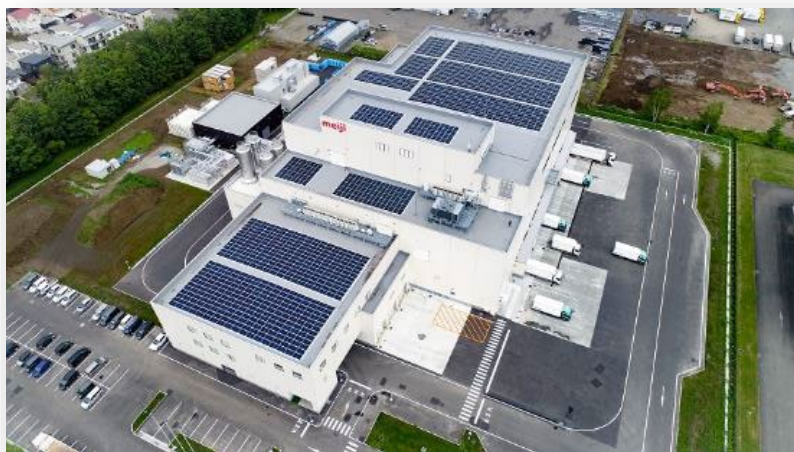
屋上に設置したソーラーパネル
