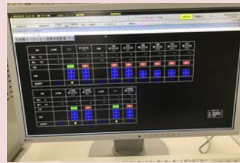
変電所マルチメーター
