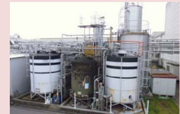
坂戸工場 メタン発酵処理施設
