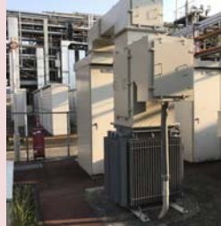
トッランナー変圧器
