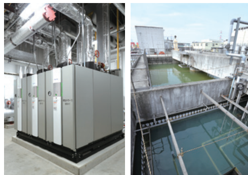
省エネタイプの高効率ボイラー 1日600トンの処理能力を持つ排水処理施設
