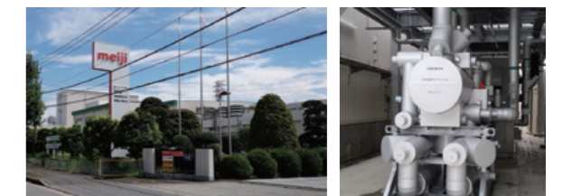
(株)明治 群馬工場 省エネ型自然冷媒機器
