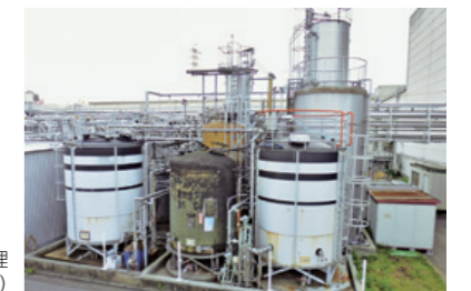
メタン発酵処理 (株)明治 坂戸工場
