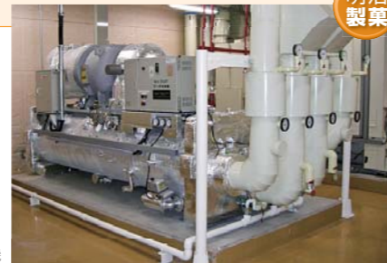
東海工場のターボ冷凍機
