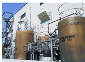
明治チューインガム（株）のメタン発酵処理施設
