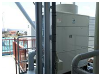
（株）明治軽井沢工場の冷凍機
