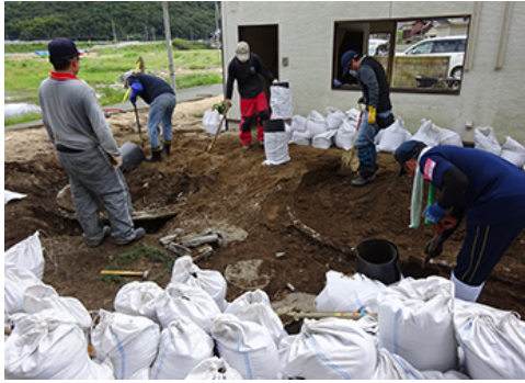
2018年10月 岡山県倉敷市真備町
