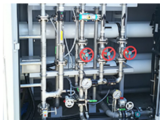
（株）明治守谷工場 RO膜設備
