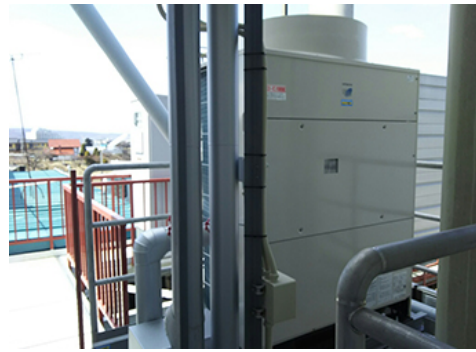
(株) 明治軽井沢工場の冷凍機
