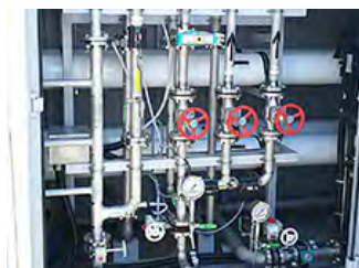
(株) 明治守谷工場 RO膜設備
