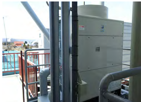
(株) 明治長野チーズ工場の冷凍機
