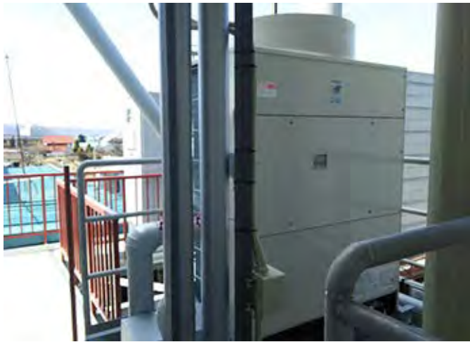
(株)明治長野チーズ工場の冷凍機
