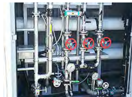
(株)明治守谷工場 RO膜設備
