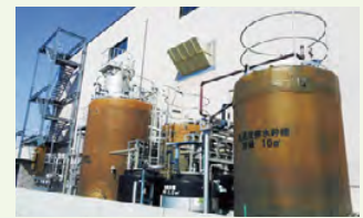
明治チューインガム(株)のメタン発酵処理施設
