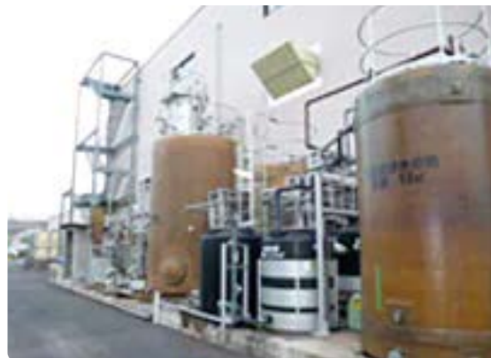
高濃度排水の自社処理を実現するメタン発酵排水処理設備
