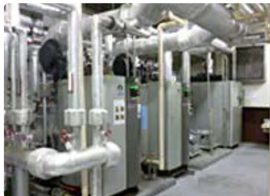
省エネタイプの高効率ボイラー
