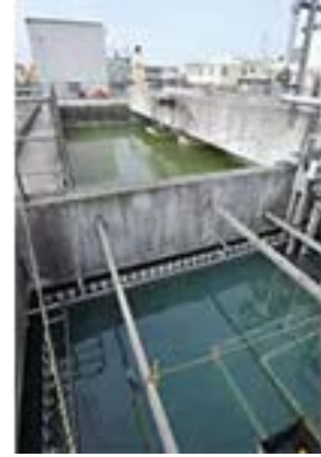
1日600トンの処理能力を持つ排水処理施設
