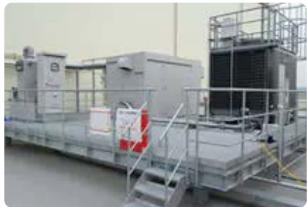
2種類の冷媒を使用して効率的に冷やす冷凍装置
