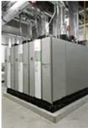
省エネタイプの高効率ボイラー
