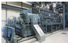
(株) 明治 十勝工場 コージェネレーションシステム
